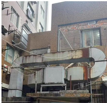
图1 改造前油烟管道
