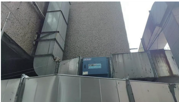
图2 改造后油烟管道
