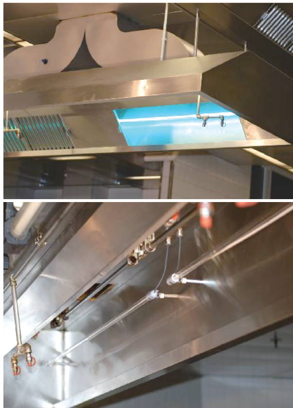
图 1 某厨房烟罩使用的紫外系统
